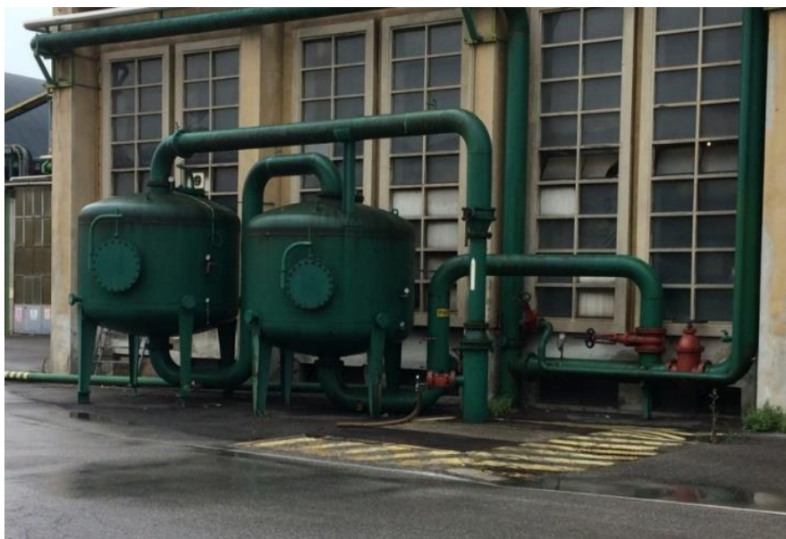
Figura 78: Vista filtri presso Pozzo P2
