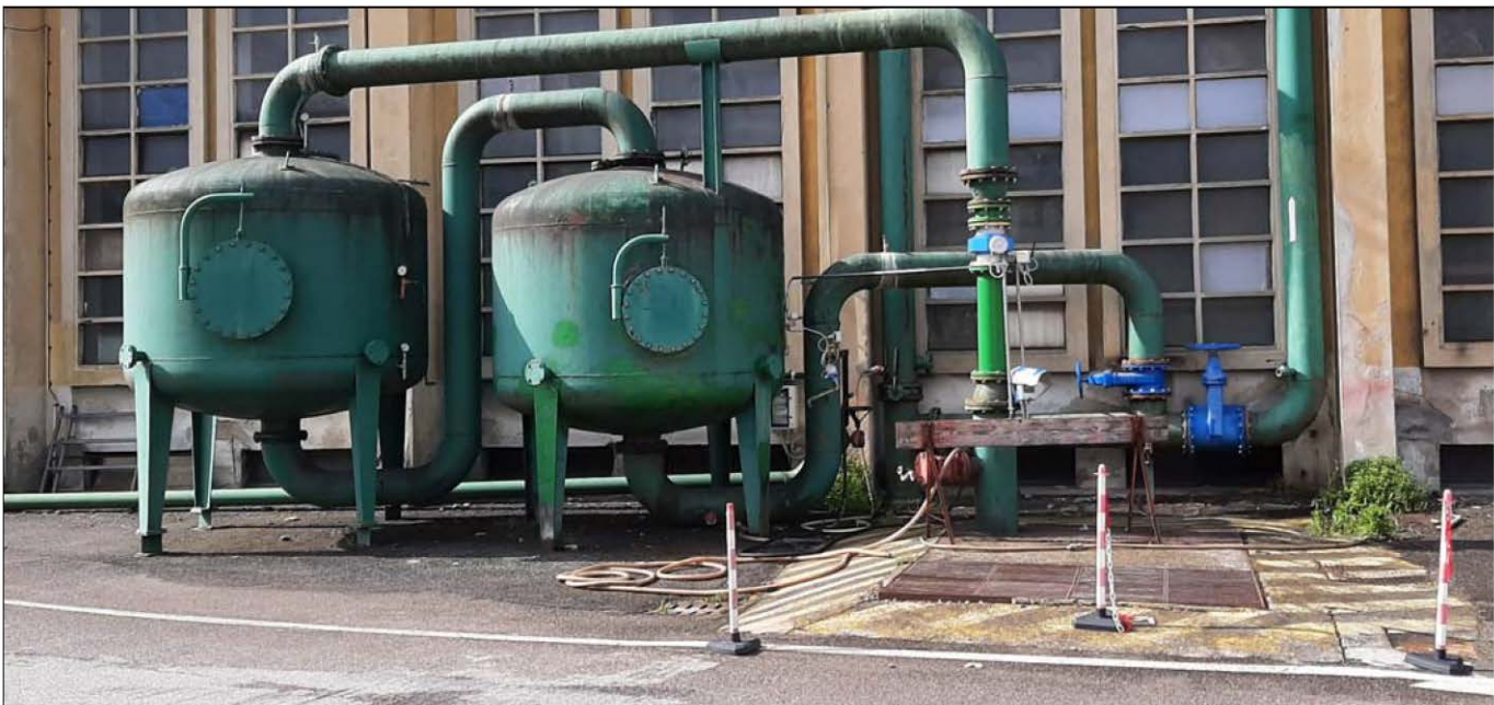
FOTO 6 – IMPIANTO DI TRATTAMENTO POZZO 2
