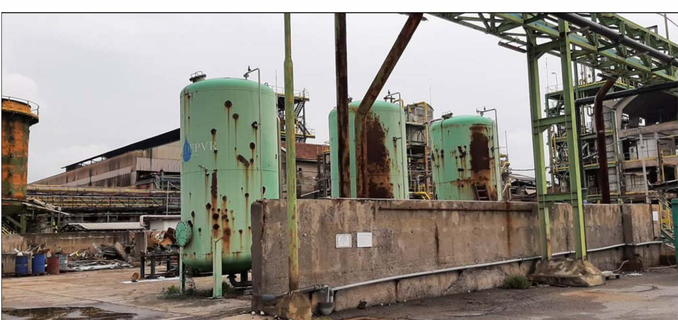
FOTO 8 – IMPIANTO DI TRATTAMENTO POZZO 7 (2012)
