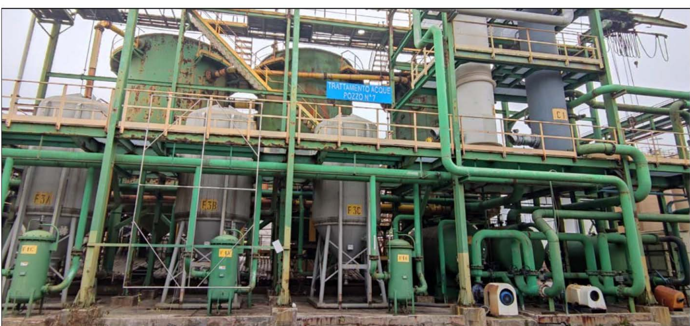
FOTO 7 – IMPIANTO DI TRATTAMENTO POZZO 7 (2002)
