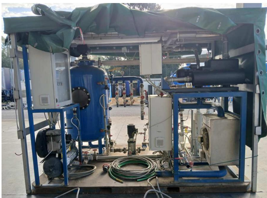
Figura 6-3 – Impianto su skid per prova SVE
