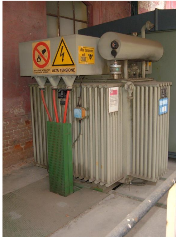
Immagine 23: Trasformatore cabina 5 – fonte ARPA dip. di Brescia
