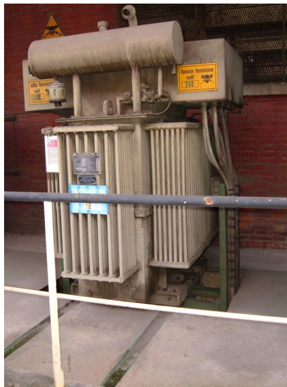
Immagine22: Trasformatore cabina 7 – fonte ARPA dip. di Brescia
